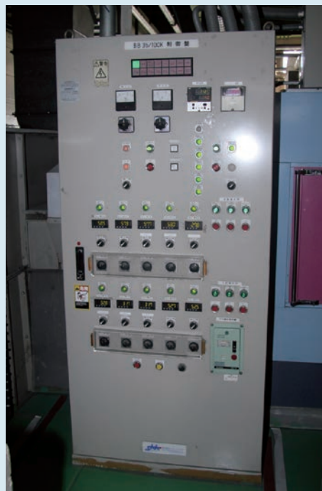
▲マルチハイブリッド乾燥システム制御盤
