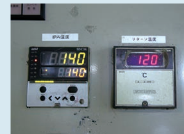
▲炉内・リターン温度表示
